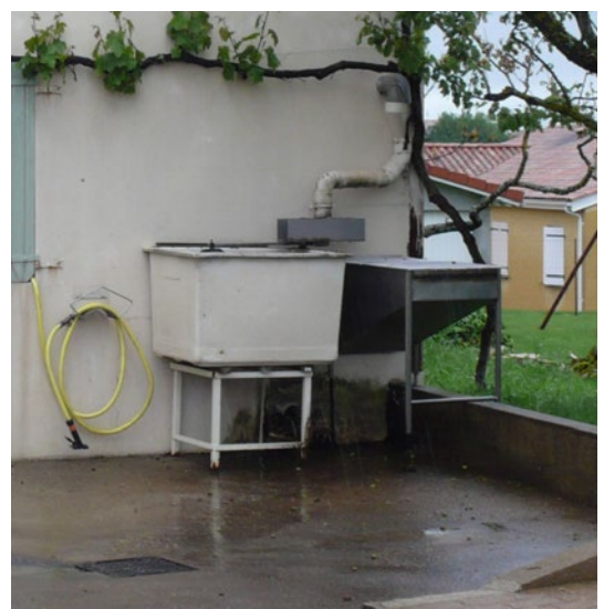
Vue des éléments : gouttière, cuve-tampon, filtre
