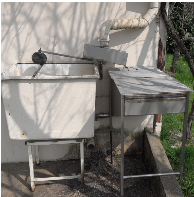
Système de récupération d'eau de pluie
